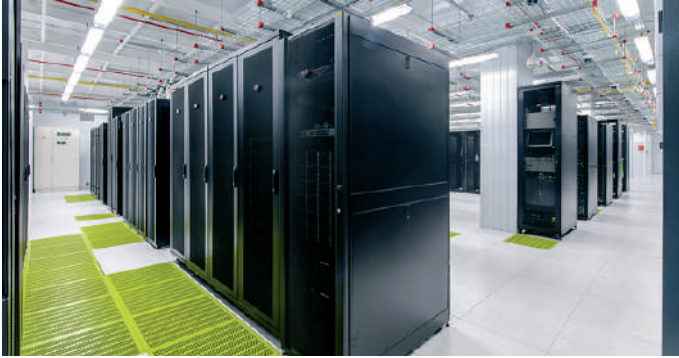
Дата-центр Сбербанка, Московская обл., Сколково
